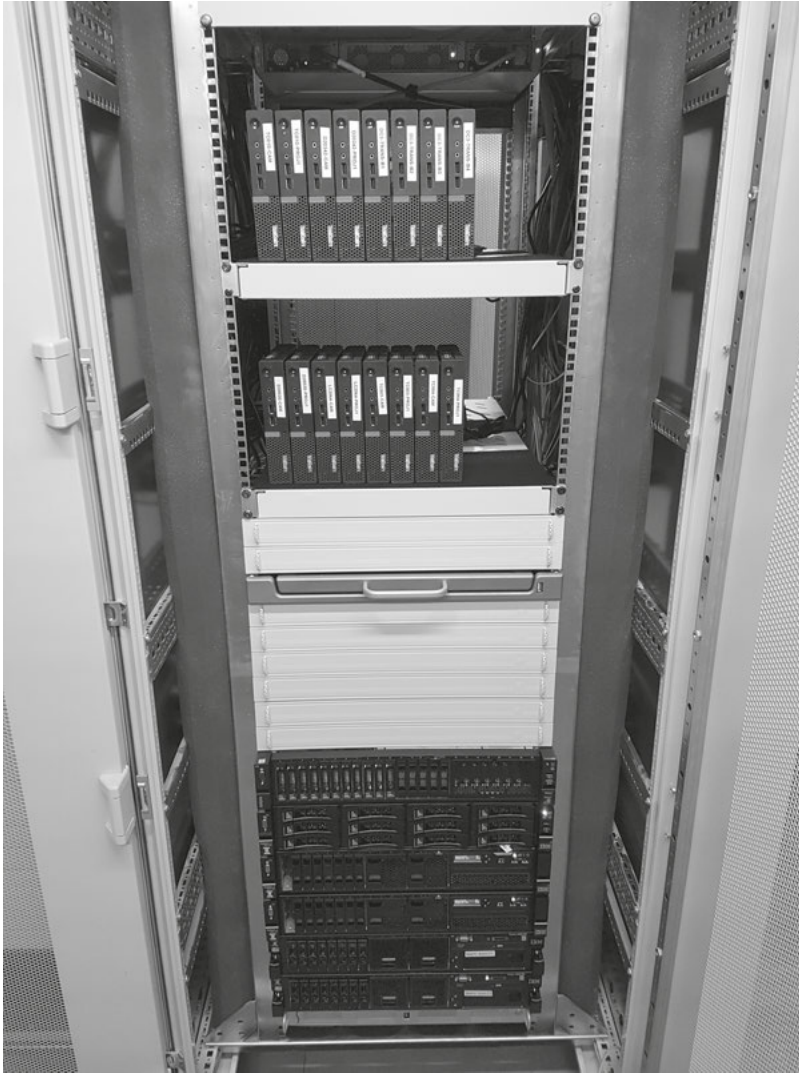
Abb. 11.14: Serverschrank des Learn@WU-Servers
