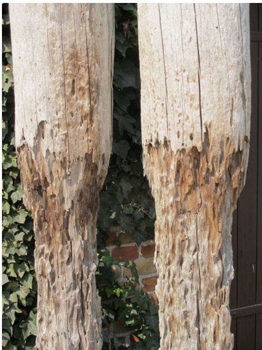
Das Ergebnis ist immer ruinös: Von Pfählobohrmuscheln zerfressene Buhnenpfähle
