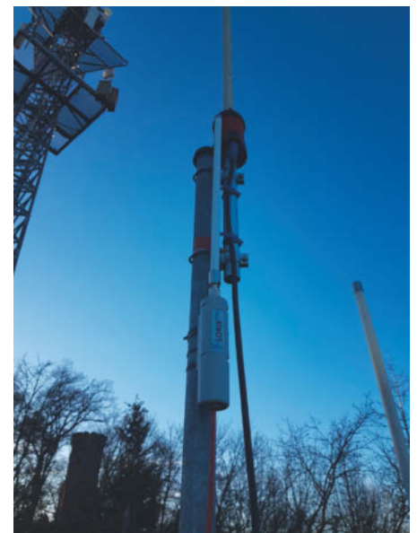
Ein LoRaWAN-Gateway an einem exponierten Standort – hier das Lorix One [3] – deckt problemlos eine kleine Stadt ab und dient, mit passender Serverinfrastruktur und ohne Sicherheitsnachteile mehreren Firmen, Behörden und der Allgemeinheit.
