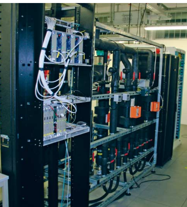
Das kleine DEEP-Testsystem am LRZ mit allen Pumpen und Röhren für die Heißwasserkühlung. Links mittig die Xeon-Phi-Karten in wasserdurchflossenen Aluminium-Blöcken.
