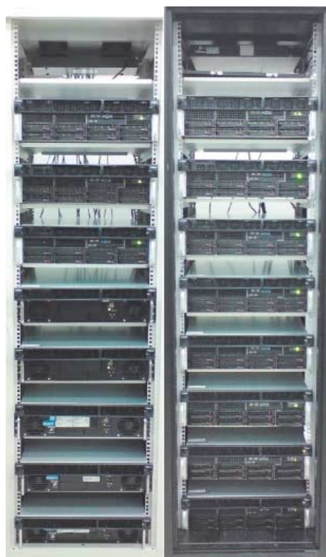
Sechzehn Tesla-S1070-Einschübe mit vier GPUs und 16 GByte Speicher schaltet die National Taiwan University zu einem 64-TFlops-Supercomputer zusammen. Die Steuerung übernehmen sechzehn Server mit je zwei Quad-Core-CPU und 32 GByte Speicher.
