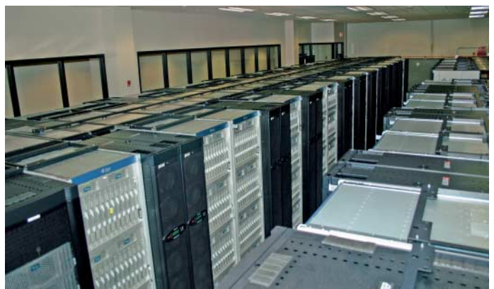
Innenansicht der Rack-Zeilen beim Ranger: Compute-Racks Sun 6048 wechseln sich mit den schwarzen APC-Kühlschränken ab.
