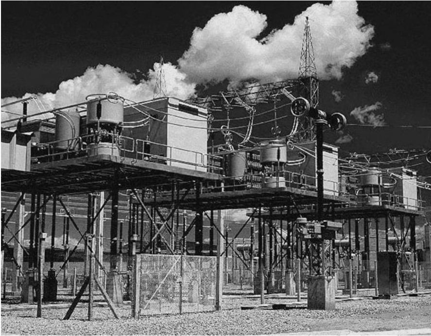
Abb. 7.43 TCSC, 107 MVar Blindleistung, 13,27 \Omega bis 39,81 \Omega Regelbereich, 500 kV, Brasilien. (Quelle: IEEE)
