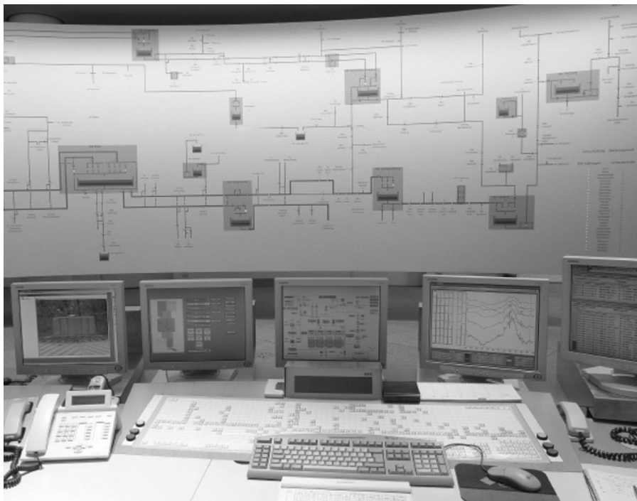
Abb. 5-33: Arbeitsplatz in der zentralen Schaltwarte einer Fernwasserversorgung (Quelle: Zweckverband Bodensee-Wasserversorgung, Stuttgart)
