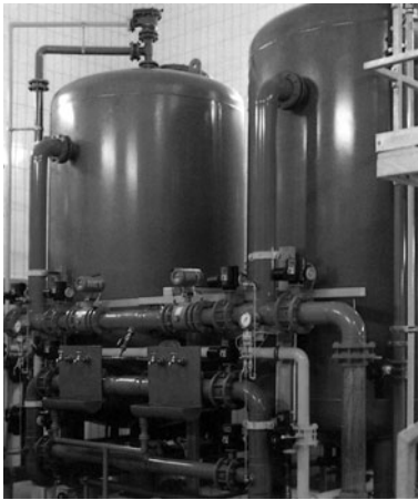
Abb. 4-60: Vollautomatische Druckfilteranlage zur Enteisung, Entmanganung und Restentsäuerung (Quelle: WLA)
