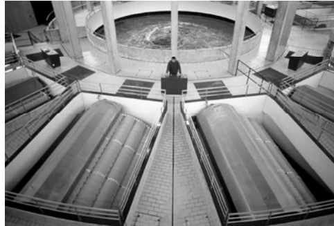
Abb. 4-59: Mikrosiebe zur Oberflächenwasser-Aufbereitung (Quelle: BWV)
