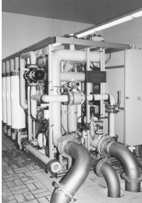
Abb. 4-48: Membrananlage zur Keim- und Trübstoffentfernung (Foto: Fritz GmbH)
