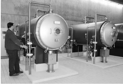
Abb. 4-58: Ozonerzeuger zur Aufbereitung von Seewasser (Quelle: BWV)
