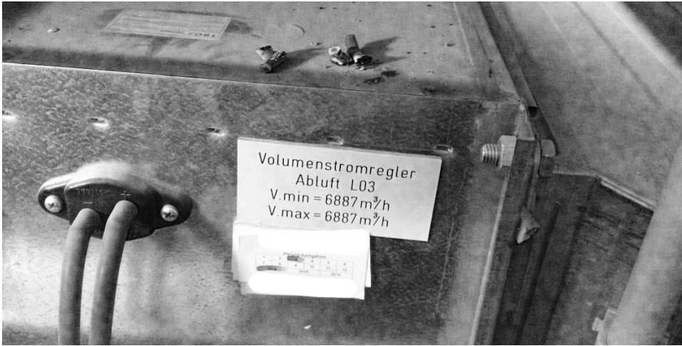
Abb. 5.27 Vorgefundener Zustand der Anlagen (Quelle: eigenes Foto)
